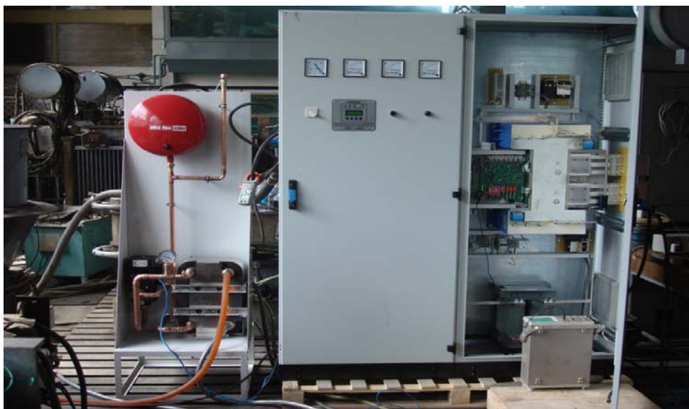
Fig. 2.2. Vedere frontală a sistemului.
